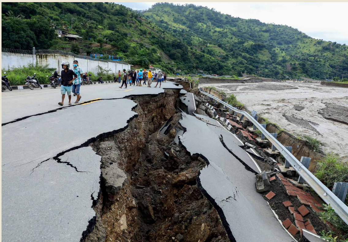
Une route endommagée à la suite d'inondations à Dili, au Timor-Leste, en avril 2021. Les inondations et glissements de terrain causés par des pluies torrentielles ont entraîné des dizaines de décès et de disparitions, après avoir touché la partie orientale de l'Indonésie et le Timor-Leste. Photo : Antonio Dasiparu/EPA-EFE/Shutterstock
